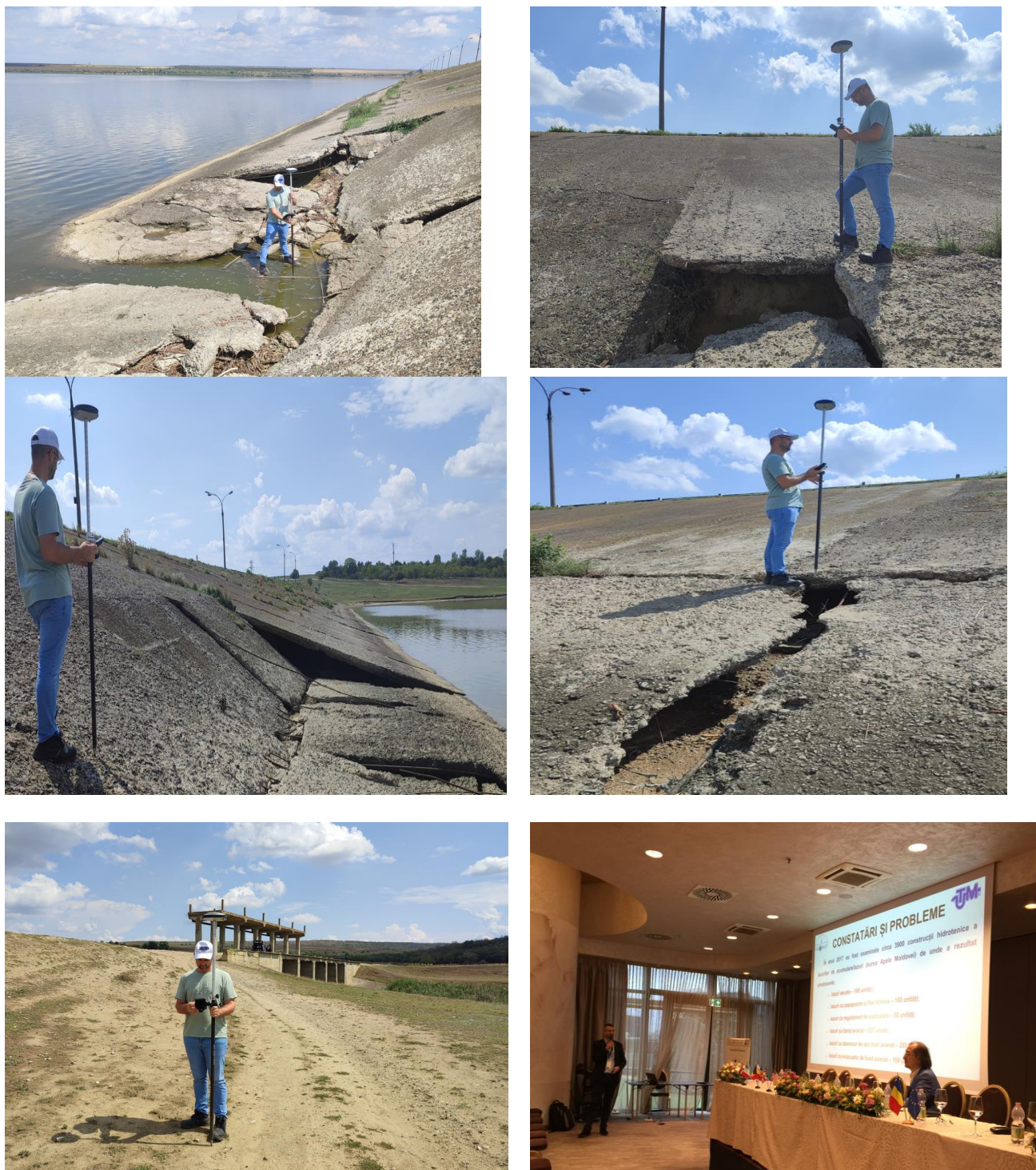
Figura 3. Lacul „Taraclia,, rl.Taraclia (barajul în întregime, construcțiile hidrotehnice, defecțiuni), monitorizarea defecțiunilor prin măsurători geodezice (GNSS), PPT, simpozionul GEOMAT
